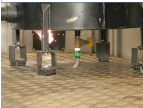
Foto 119. Registro de vazão do tanque
