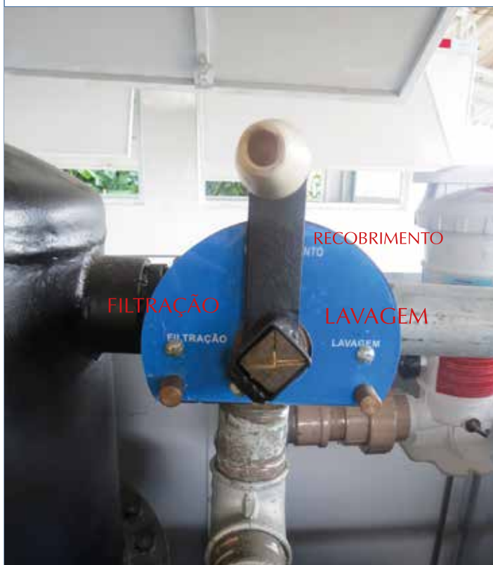
Foto 64. Válvula 1 (recobrimento, lavagem e filtração)
