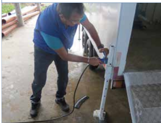
Foto 32. Trailer 1 da bomba
