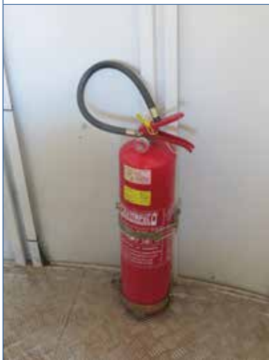
Foto 146. Extintores de incêndio
