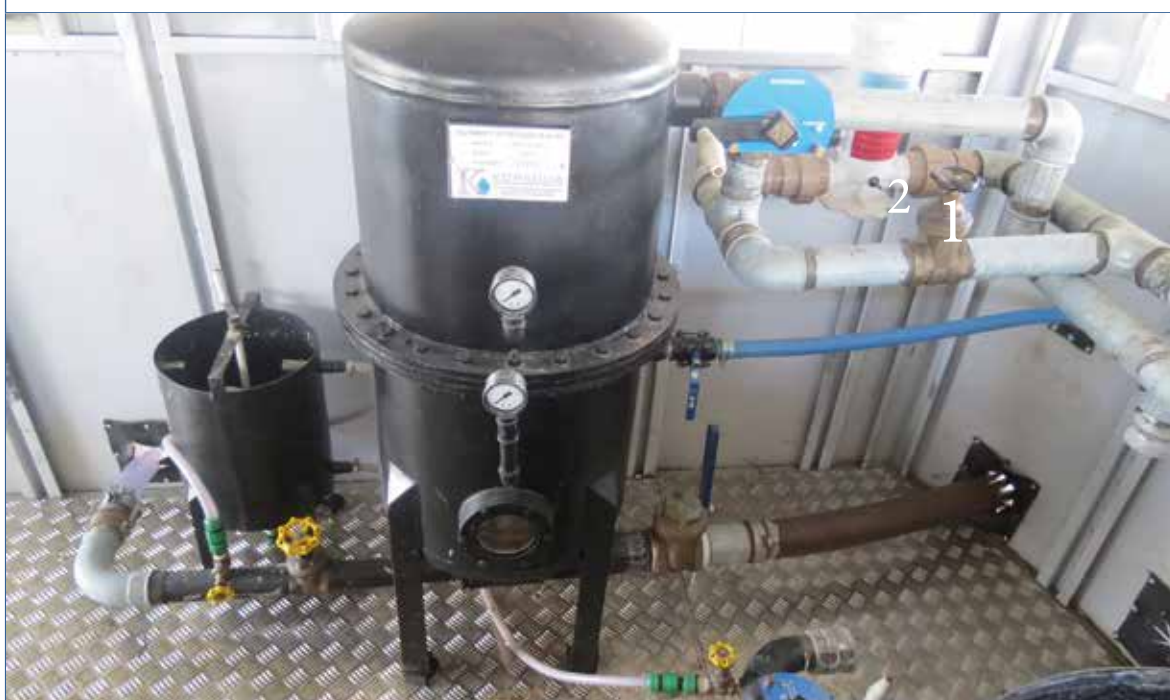
Foto 94. Registros que regulam o cloro na água tratada
