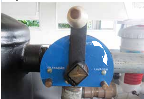
Foto 103. Válvula 1 (Posicionamento de lavagem das velas e do filtro)
