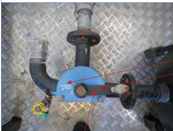
Foto 65. Válvula 2 (filtração lavagem e recobrimento)
