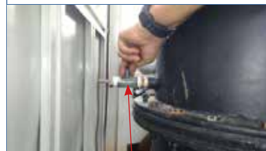
Foto 106. Válvula de escape de pressão
