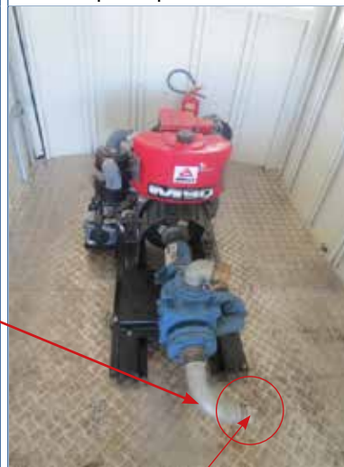
Foto 54. Entrada de água da bomba principal
