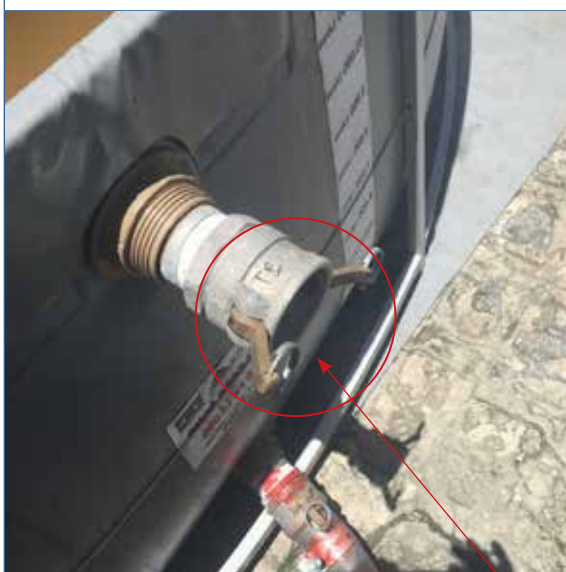
Foto 50. Ponto de entrada de água bruta
