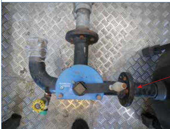
Foto 59. Ponto de ligação com o tanque – válvula fixa
