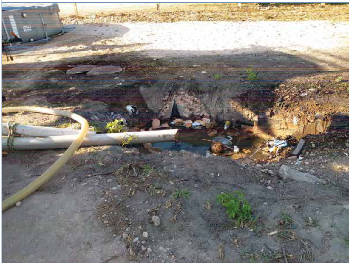
Foto 109. Vala (improvisada) utilizada para descarte dos resíduos de retrolavagem da UMTA
