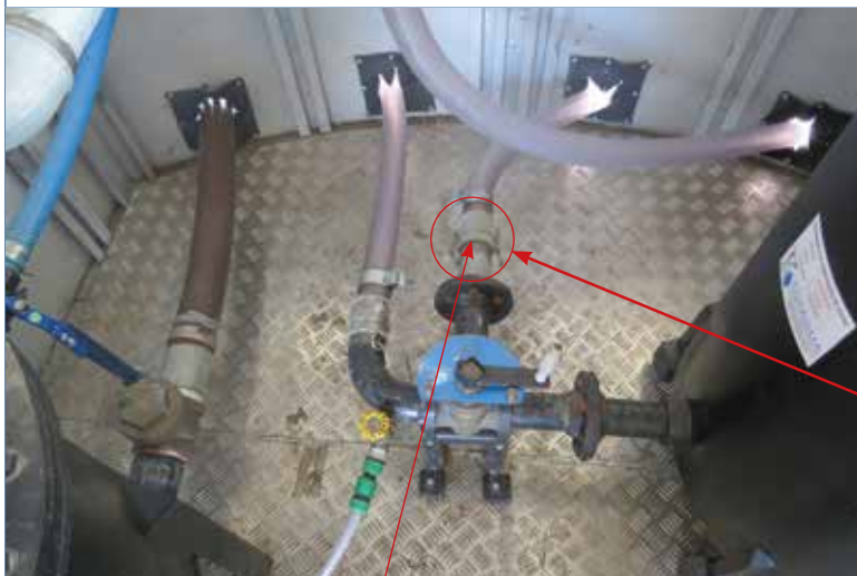
Foto 53. Saída de água para a bomba principal
