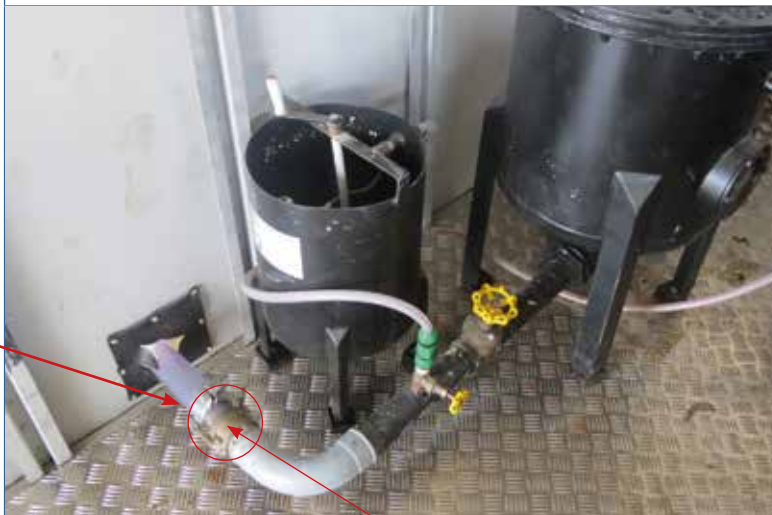
Foto 56. Entrada de água para o filtro
