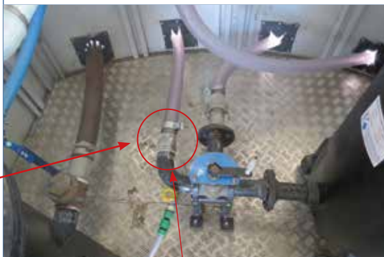
Foto 52. Entrada de água bruta
