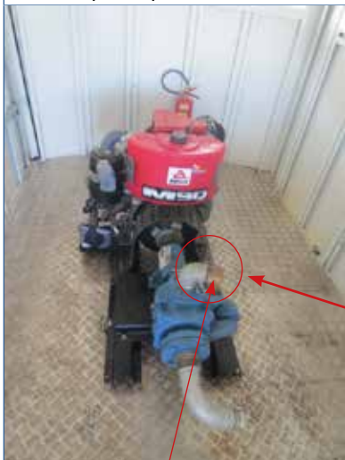
Foto 55. Saída de água da bomba principal
