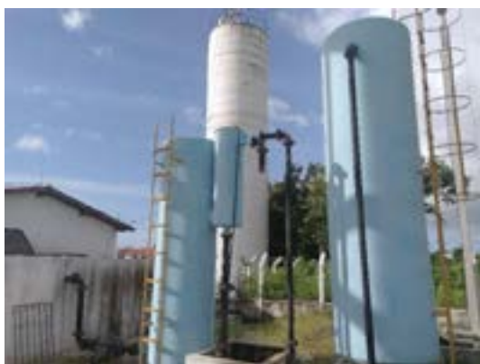
Figura 22 – Filtro rápido descendente em comunidade rural do estado do Ceará.
