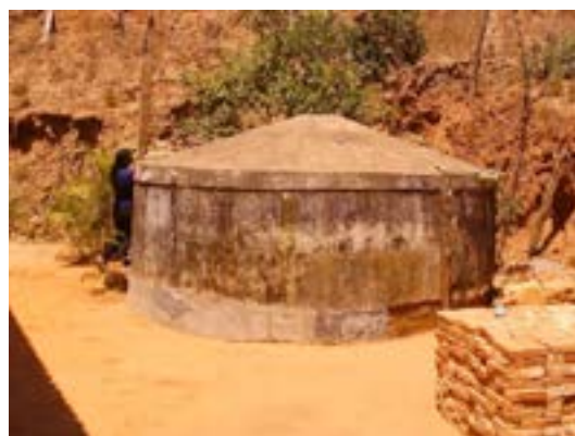
Figura 30 – Cisterna de placas para captação de água de chuva na Comunidade Quilombola de Pinheiros, no município de Moça Santa/MG.
