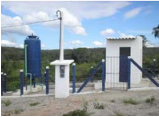
Figura 36 – Sistema de Abastecimento de Água em localidade rural da Central II. Fonte: Vieira (2016).
