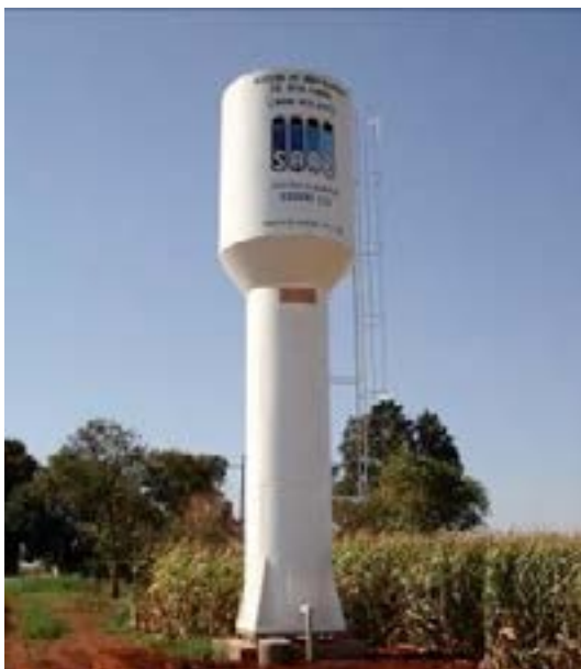
Figura 29 – Reservatório de distribuição de água em área rural de Marechal Cândido Rondon/PR.
