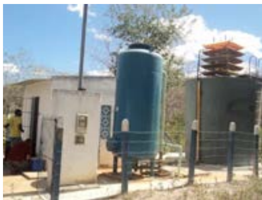
Figura 35 – Sistema de Abastecimento de Água em localidade rural da Central I.
