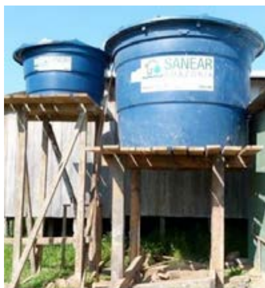
Figura 52 – Reservatórios elevados de 1000 e 5000L.
