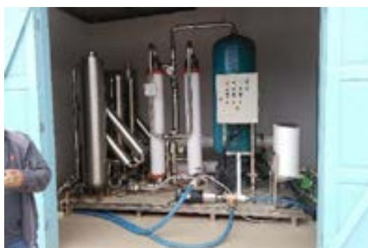
Figura 25 – Estação de tratamento de água compacta com ultrafiltração em comunidade rural do município de Castelo/ES.
