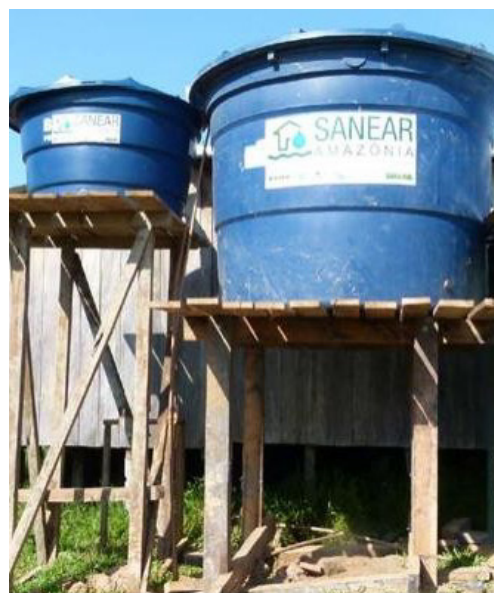
Figura 27 – Reservatórios elevados de 1000 e 5000L.
