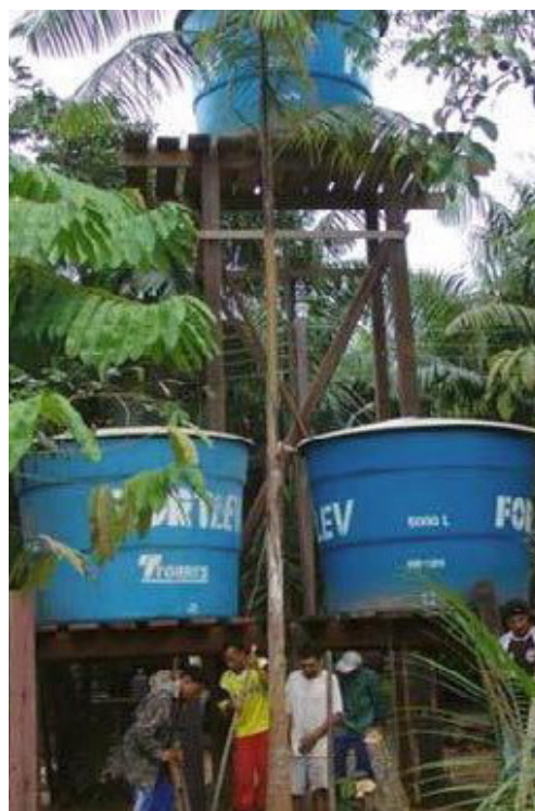
Figura 31 – Reservatórios comunitários e filtro de areia. Fonte: FBB (2017).
