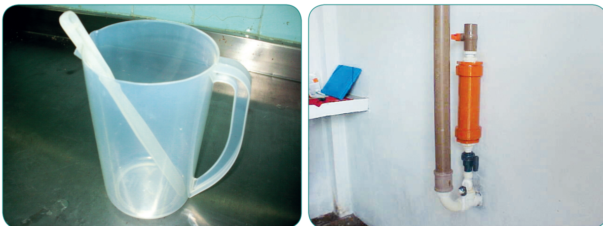
Figura 7. Recipiente de preparo de solução e clorador instalado.
