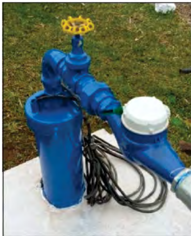
Figura 1 - Vista da parte externa de um poço mostrando o registro e o hidrômetro
