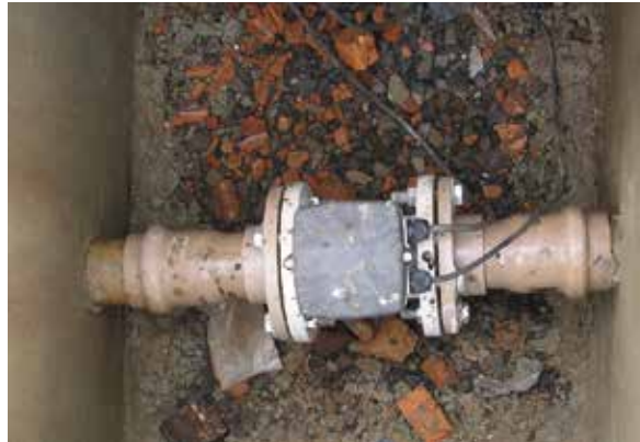
Figura 4 – Macromedidor instalado na entrada do sistema
