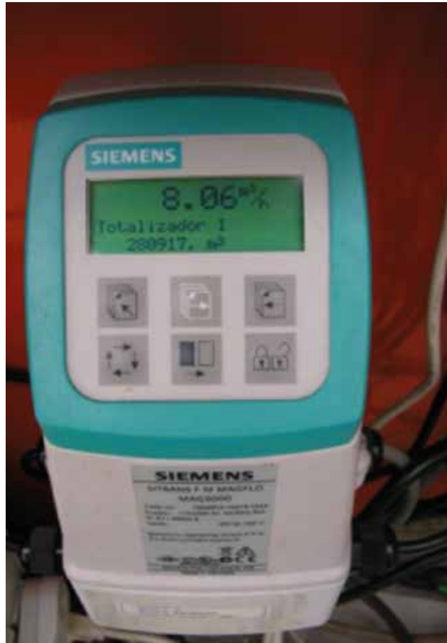
Figura 23 – Conversor do macromedidor do setor da Subestação
