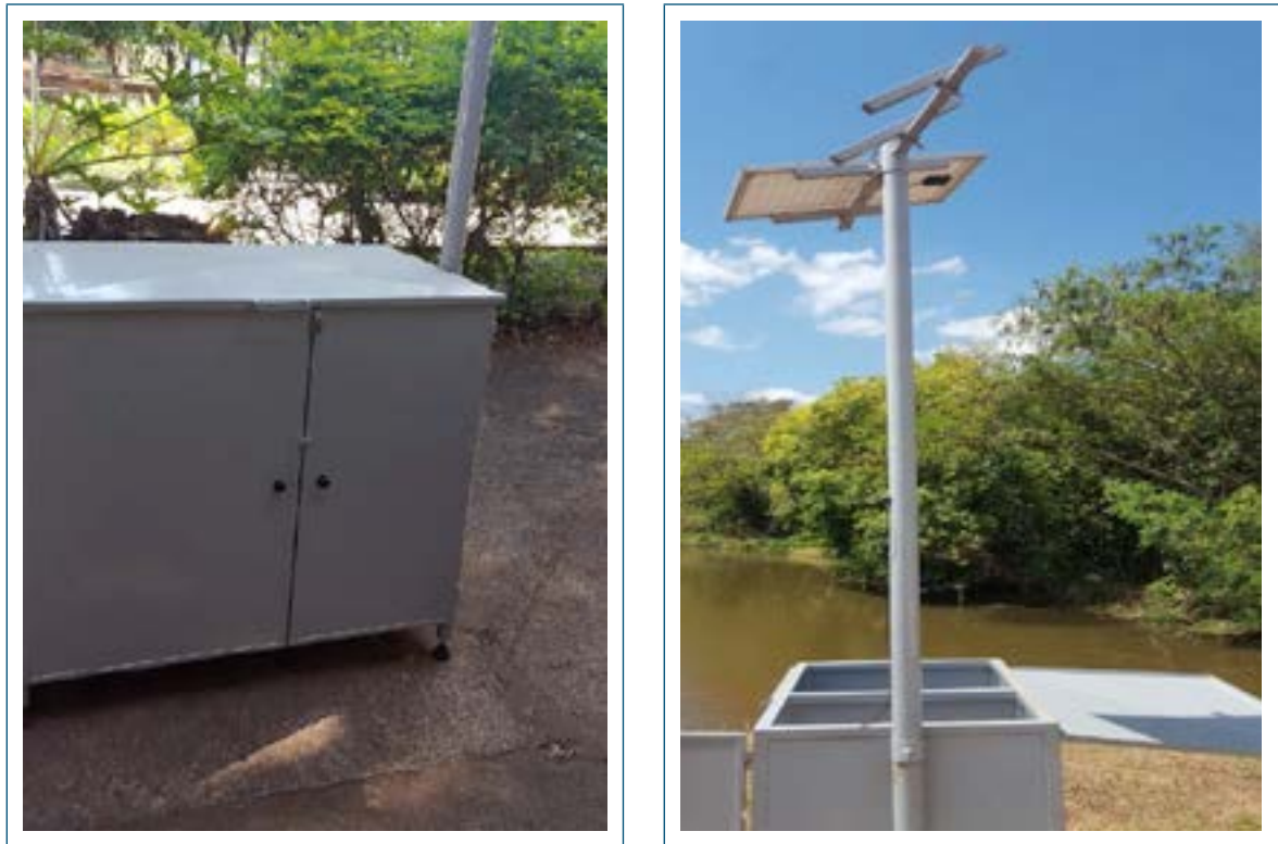
Figura 8 – Base metálica com painel solar para estação rádio-base.
