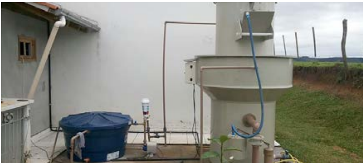
Figura 28 – Sistema de filtração instalado na escola Leandro dos Santos, Ituporanga, SC.
