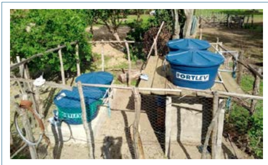
Figura 2 – Vista do sistema de tratamento piloto concluído.
