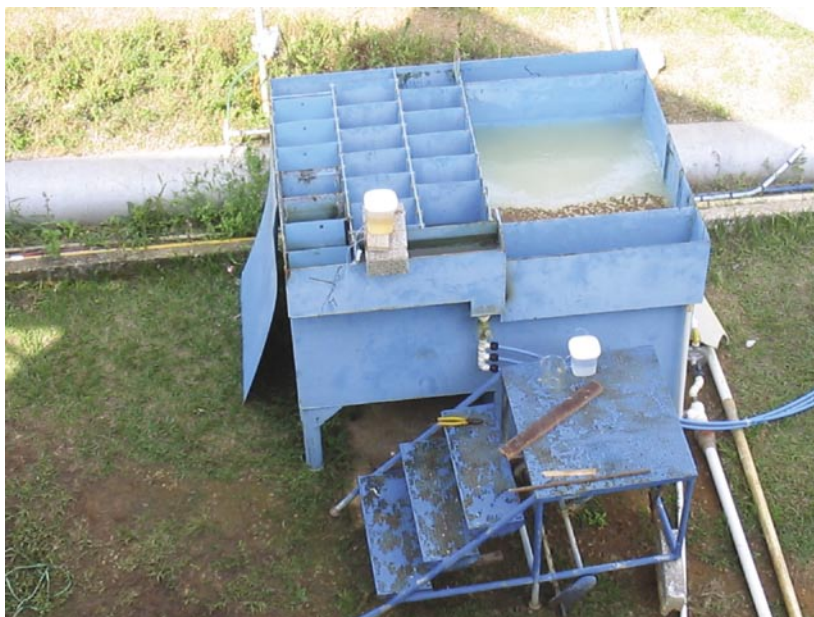
Figura 3 – ETA piloto onde foram desenvolvidos os experimentos, ao lado da ETA Duas Bocas, próximo à barragem.
