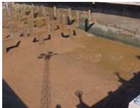
Figura 1: Lodo depositado no fundo do decantador
