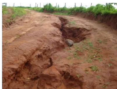
Erosão em estrada impede a passagem de veículos
