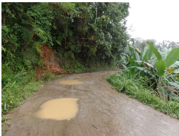
Figura 15 – Empoçamento das estradas
