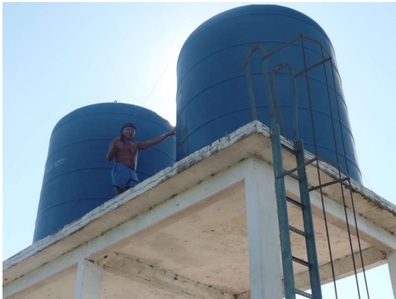
Figura 34 – Reservatório de água elevado sem local de apoio
