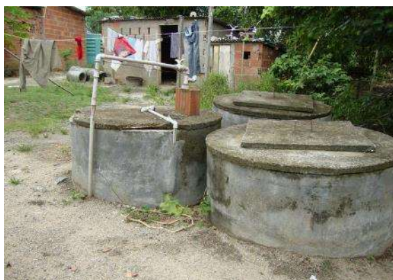
Figura 111 – Reservatórios para armazenamento de água proveniente da ProLagos
