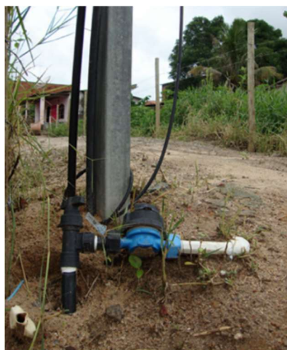
Figura 100 – Hidrômetros implantados nas residências pela ProLagos
