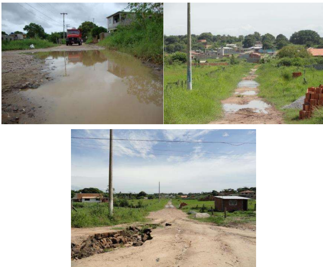
Figura 135 – Imagens de algumas vias um dia após uma forte chuva em Botafogo
