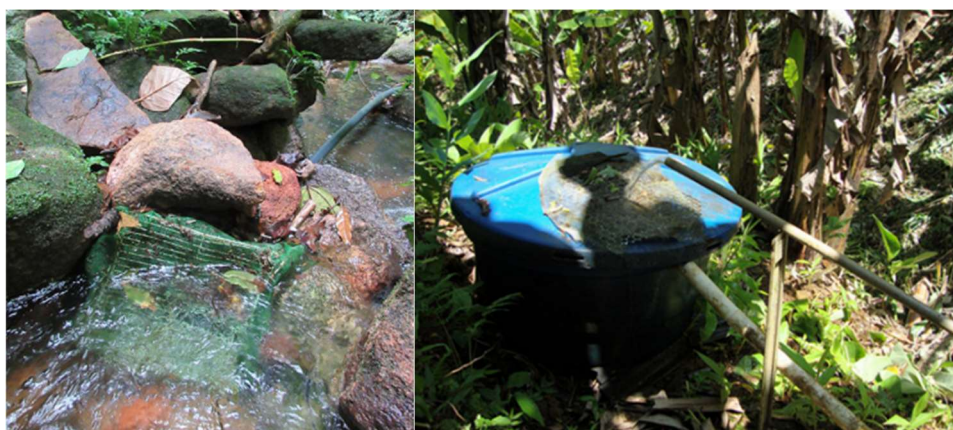
Figura 164 – Materiais utilizados para evitar que partículas grandes adentrem nas mangueiras ou nas tubulações
