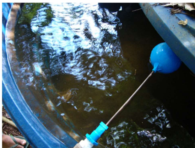
Figura 168– Caixa d'água com grande quantidade de material sedimentado
