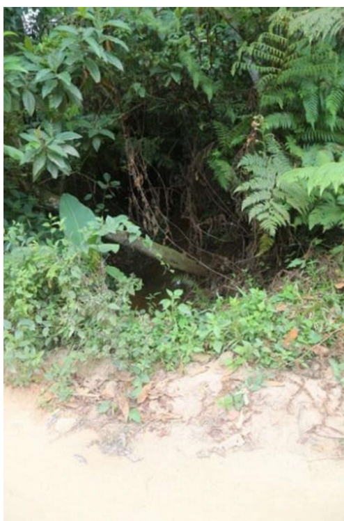
Figura 188 – Valeta próxima às casas localizadas perto da estrada
