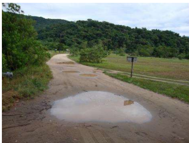
Figura 189 – Buracos com acúmulo de água, na estrada principal próximo à praia
