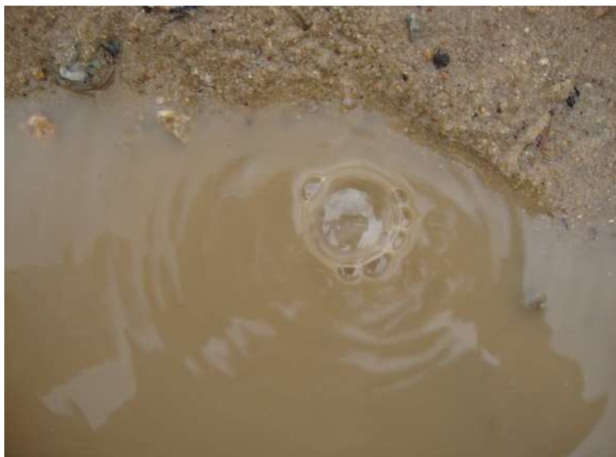
Figura 109 – Poça de água na via principal da comunidade, decorrente de vazamento de água, devido à ruptura de canalização
