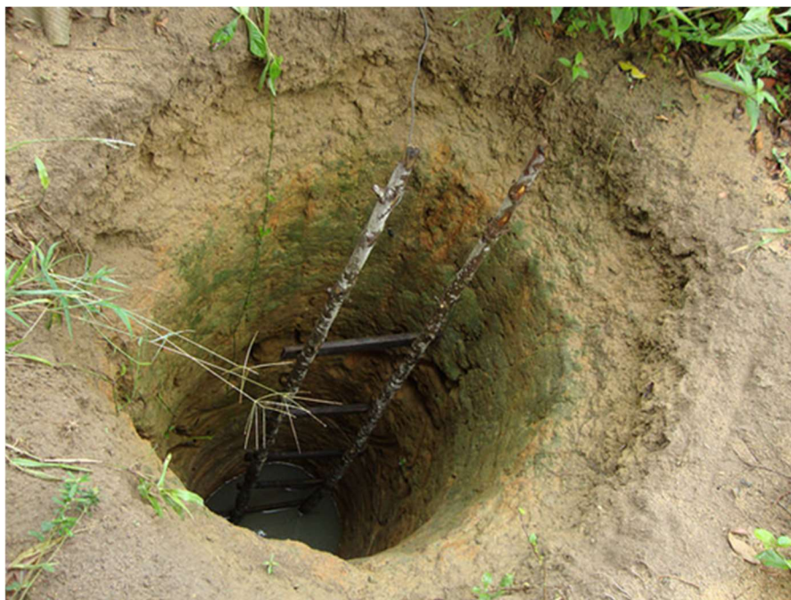
Figura 32 – Poço escavado manualmente, sem nenhuma estrutura de contenção
