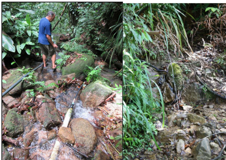
Figura 158 – a) Captação e adução de água utilizando mangueiras; b) Captação de água de nascente utilizando cano de PVC
