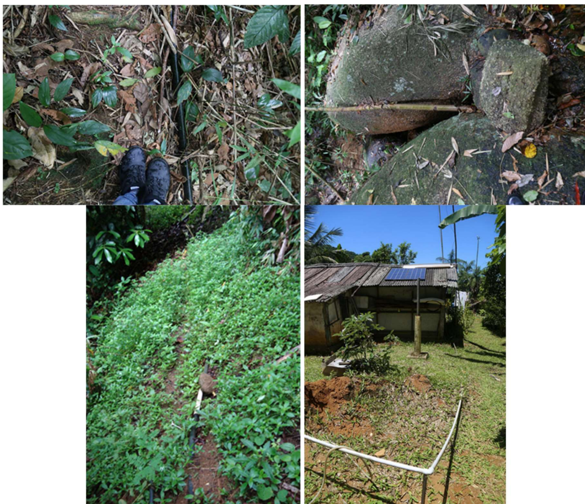
Figura 162 – Mangueiras e tubulação utilizadas para adução da água, sem proteção
