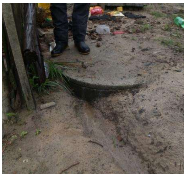
Figura 57 – Extravasamento de efluentes na fossa de um dos moradores
