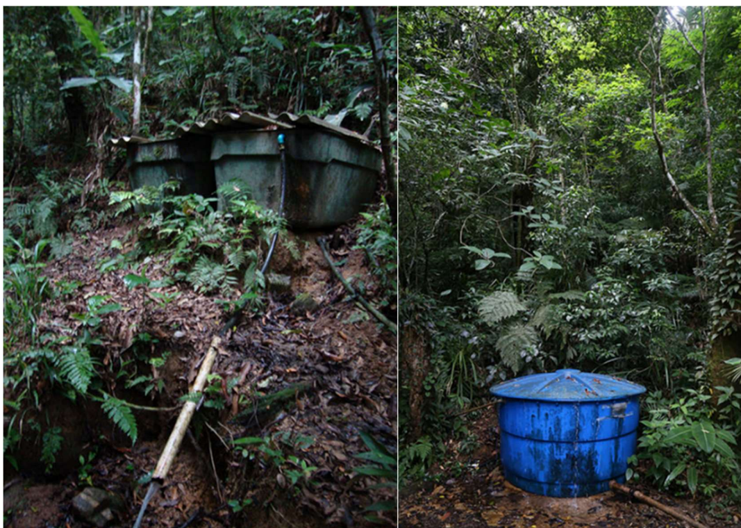
Figura 160 – Caixas d'água coletivas, utilizadas para reservação da água, com detalhe para a a tubulação que serve como extravasor para o excedente de água
