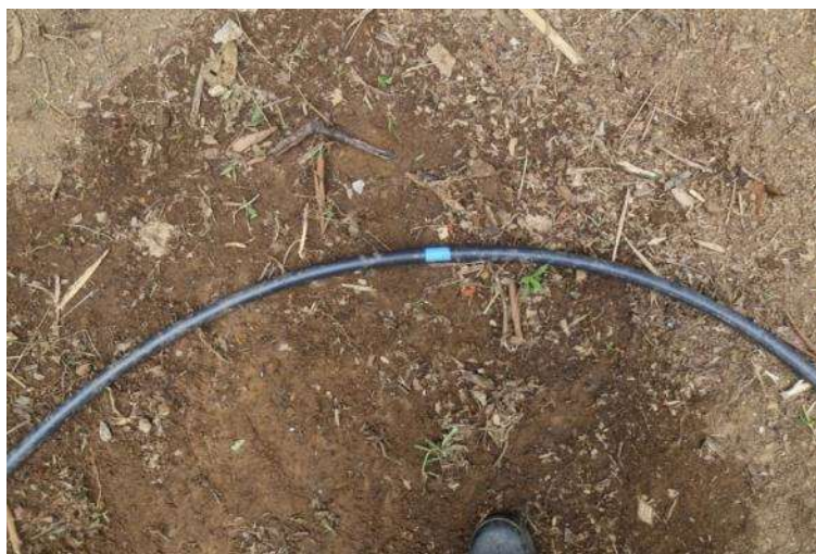
Figura 193 – Emenda da mangueira de abastecimento de água, sem anel, em solo encharcado e próximo à fossa
