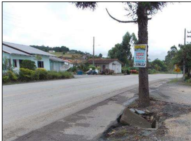
Figura 51 – Estrutura de drenagem pluvial danificada, na frente da casa de um morador
