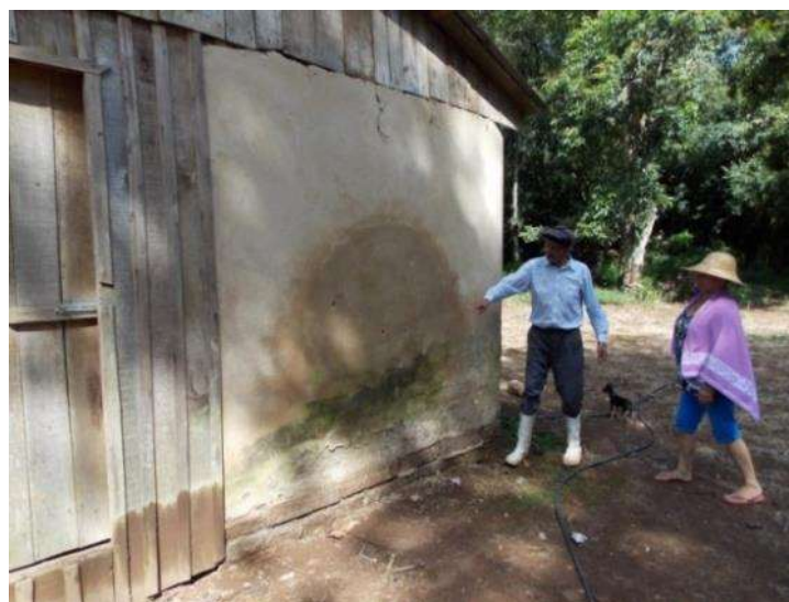
Figura 85 – Casa de morador atingida pela enchente na altura indicada por ele.
